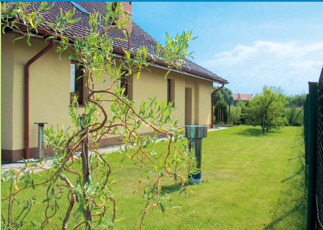
Gruntowy powietrzny wymiennik ciepła PROVENT GEO w domowej instalacji
